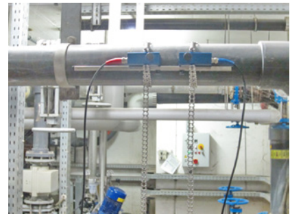
Thermal energy metering at Stadtwerke München
